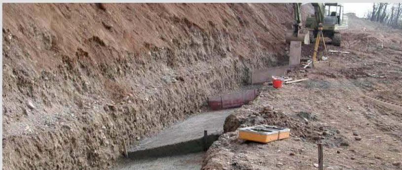
In caso di dislivelli la platea di fondazione continua va eseguita a gradoni.
